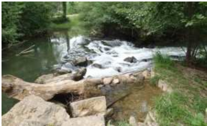
Brèche dans le déversoir de l'usine à Velars-sur-Ouche avant travaux.
