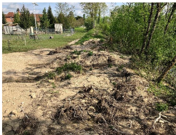
Merlon au droit de la surverse après la crue.
